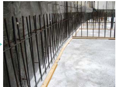
⑥ 打継部との隙間がないこと、 ジョイント部分の密着を確認。
